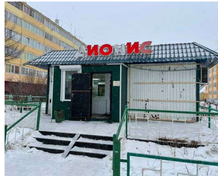
Плохо Сломанная вывеска и остаток рекламной конструкции на фасаде магазина
