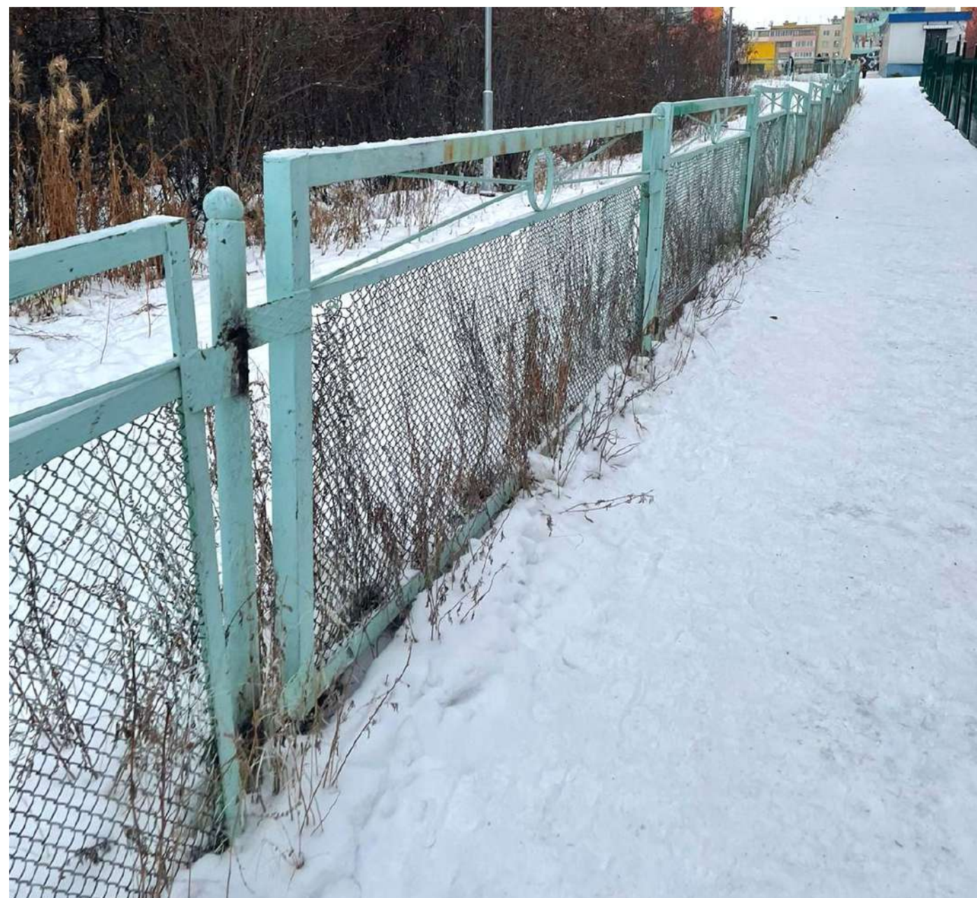
Плохо Необходимо обновления покраски или установка нового ограждения
