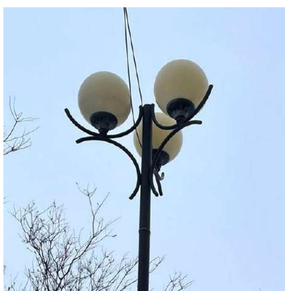
Плохо Устаревший внешний вид
