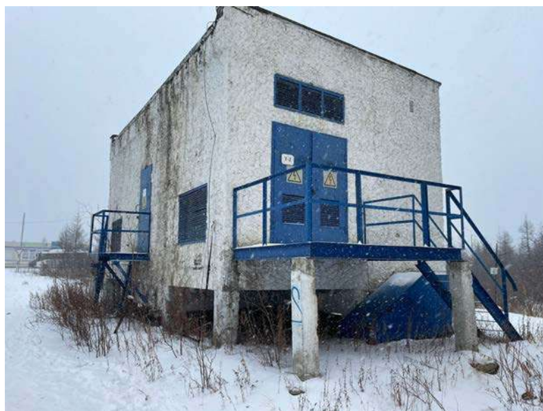
Терпимо Фасад теплового пункта нуждается в обновлении
